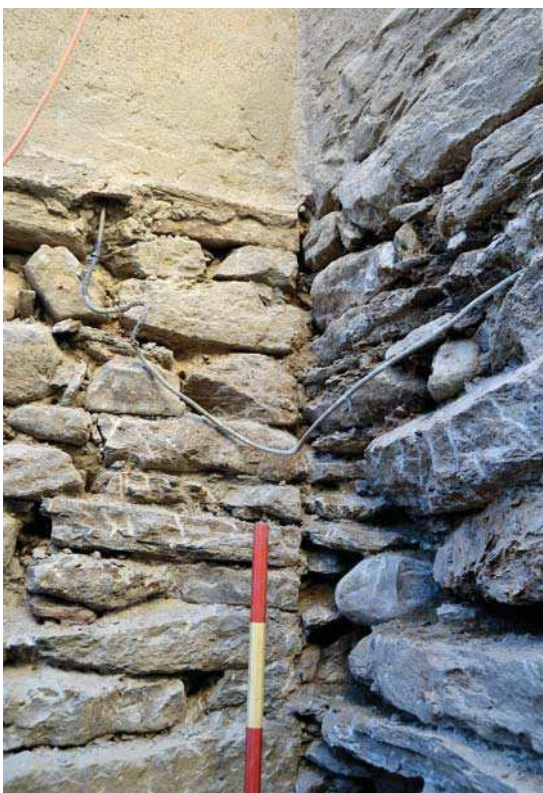
Fig. 11. Ossana, Cusiano, chiesa di Santa Maria Maddalena. Muro del campanile a destra, in appoggio al perimetrale dell'edificio sacro.
